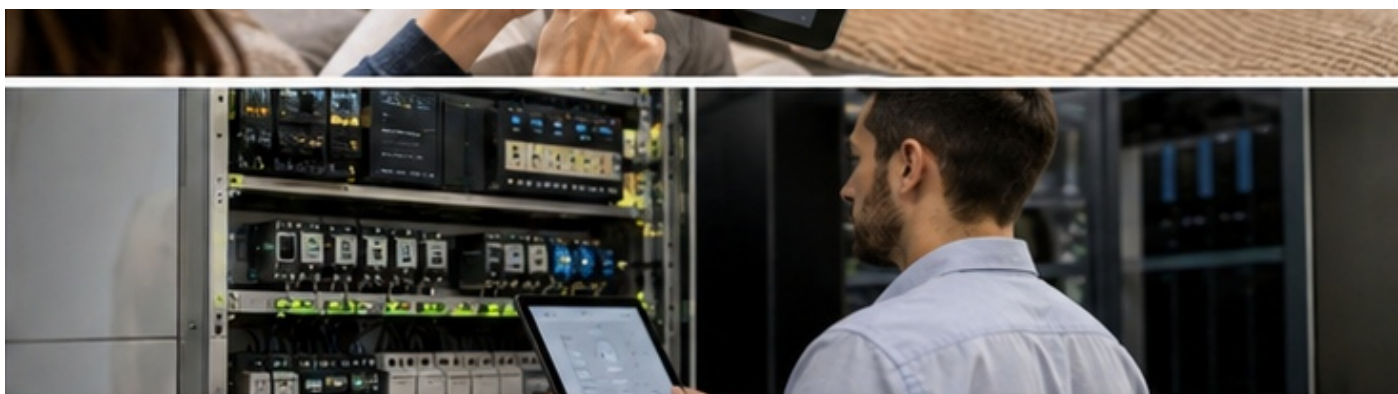
Foto 10 Arquitectura de interconexión: equipos de comunicaciones y control que vinculan dispositivos, redes y servicios dentro de una instalación domótica.
