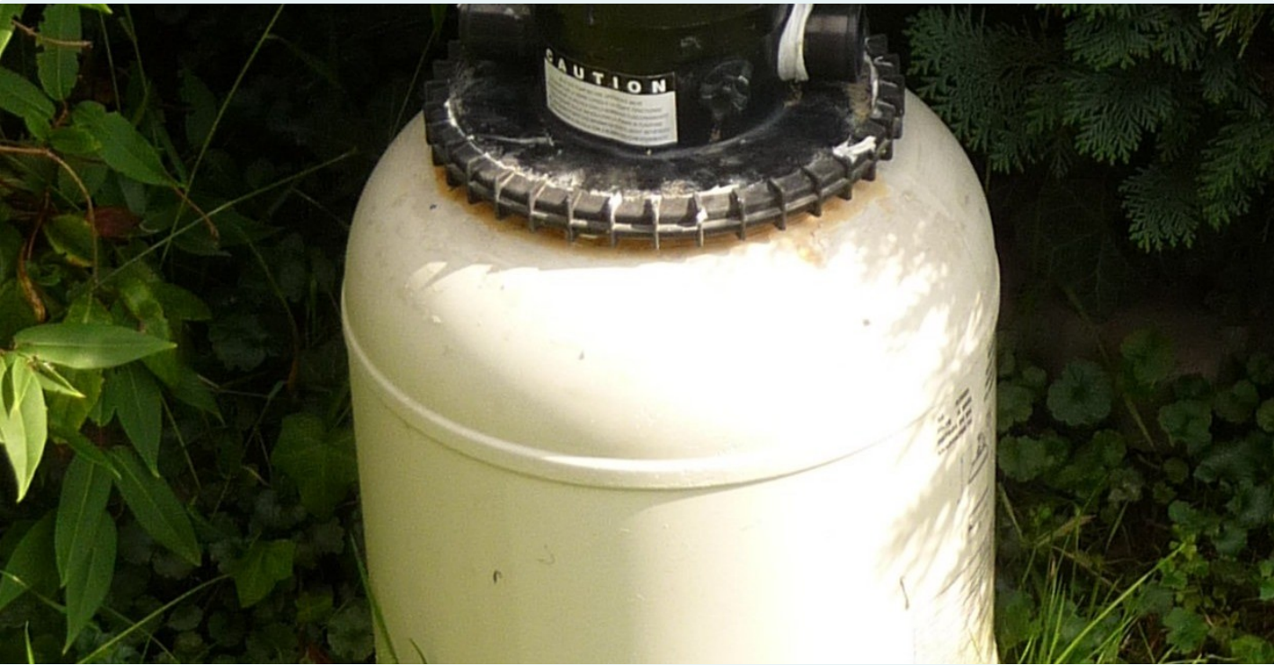
Foto 1. Sistema de filtración de piscina
