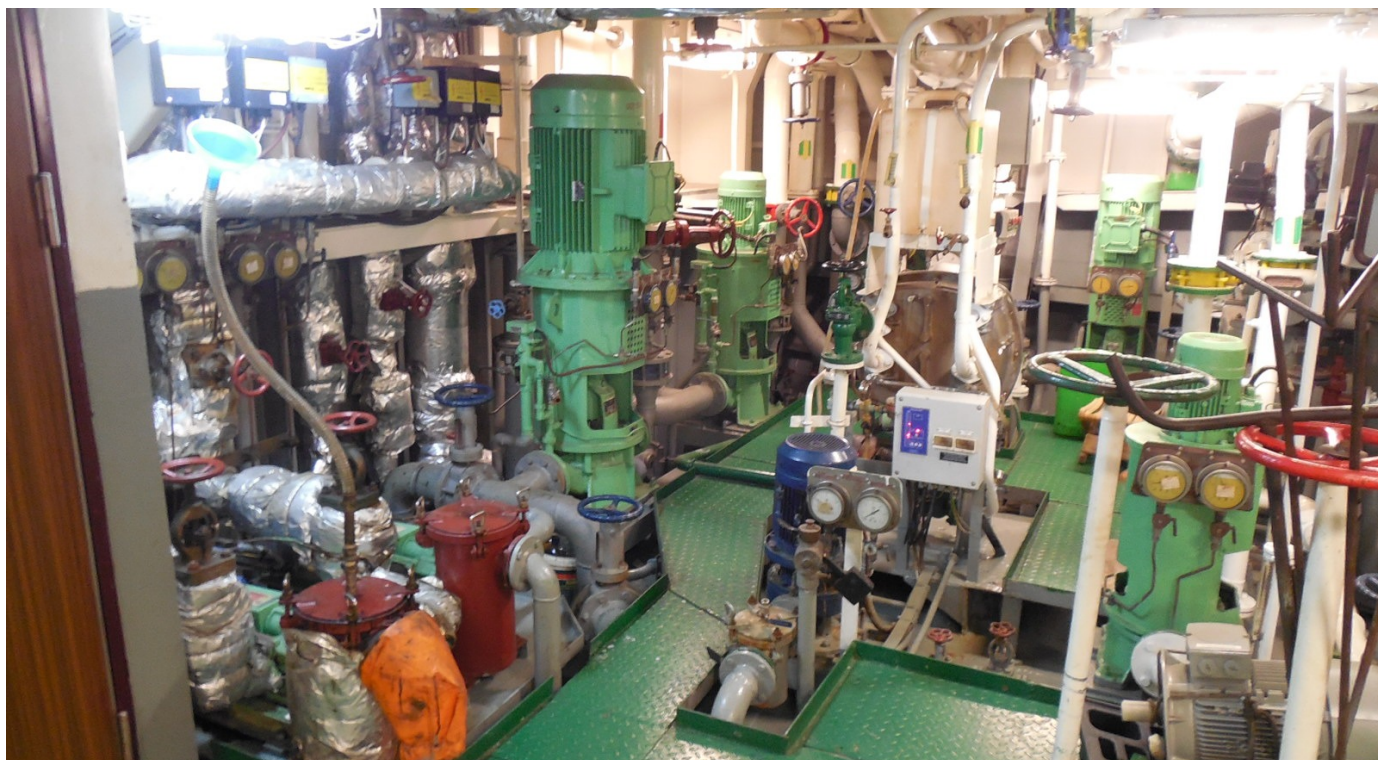
Sala de máquinas de un buque con bombas, tuberías, válvulas, motores y sistemas auxiliares, elementos esenciales para comprender el funcionamiento mecánico a bordo.
