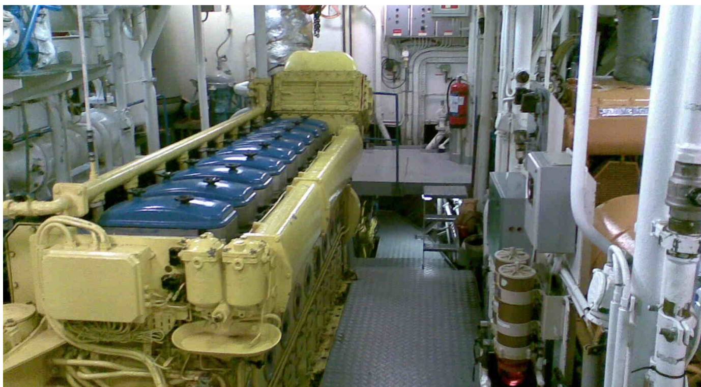
Motor diésel marino instalado en la sala de máquinas. La imagen ayuda a identificar componentes, disposición del motor y condiciones reales de trabajo en un buque.
