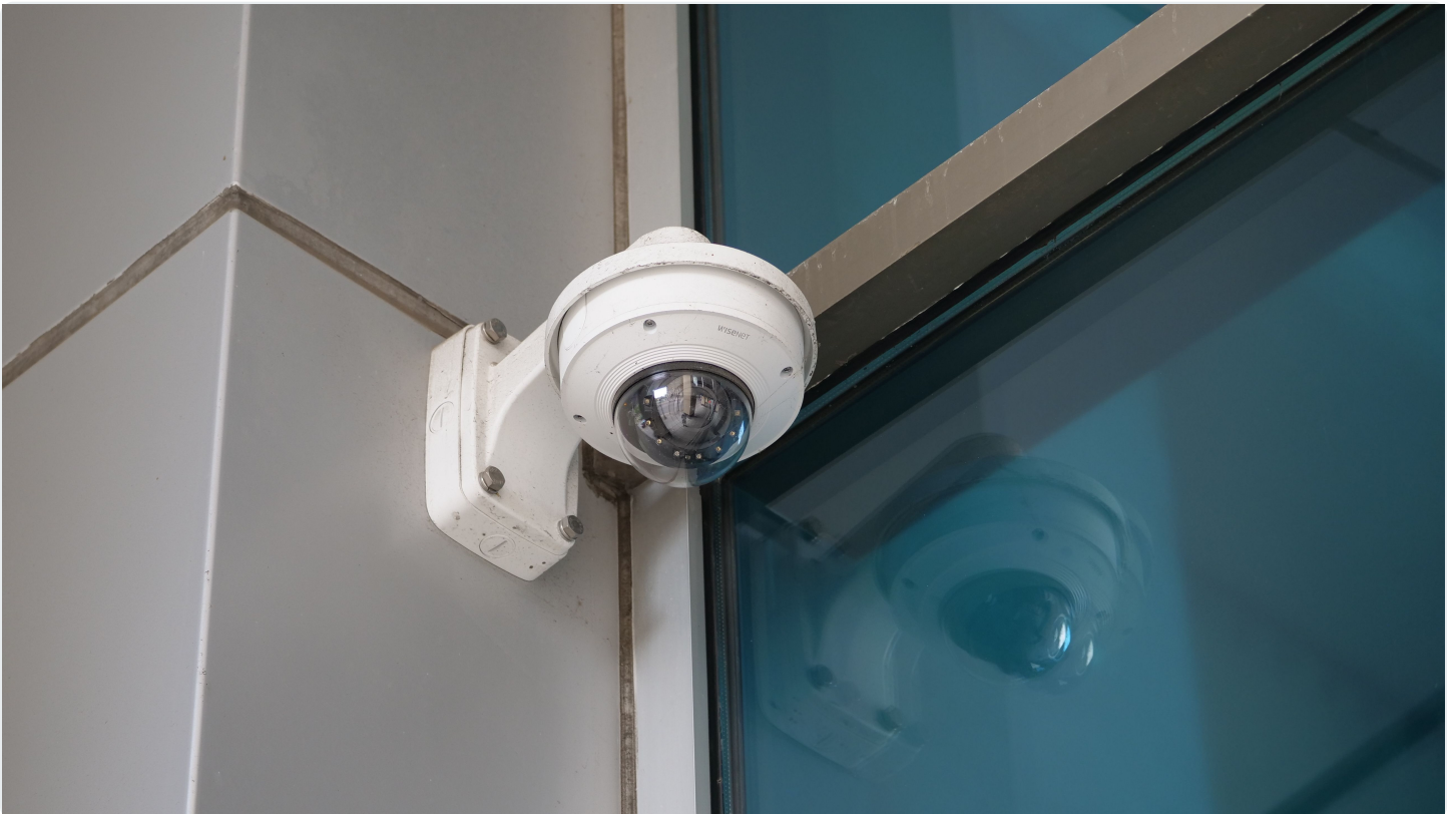
10. Cámara domo instalada en el acceso de un edificio, relacionada con videovigilancia, identificación de movimientos y apoyo a los sistemas de control de accesos.
