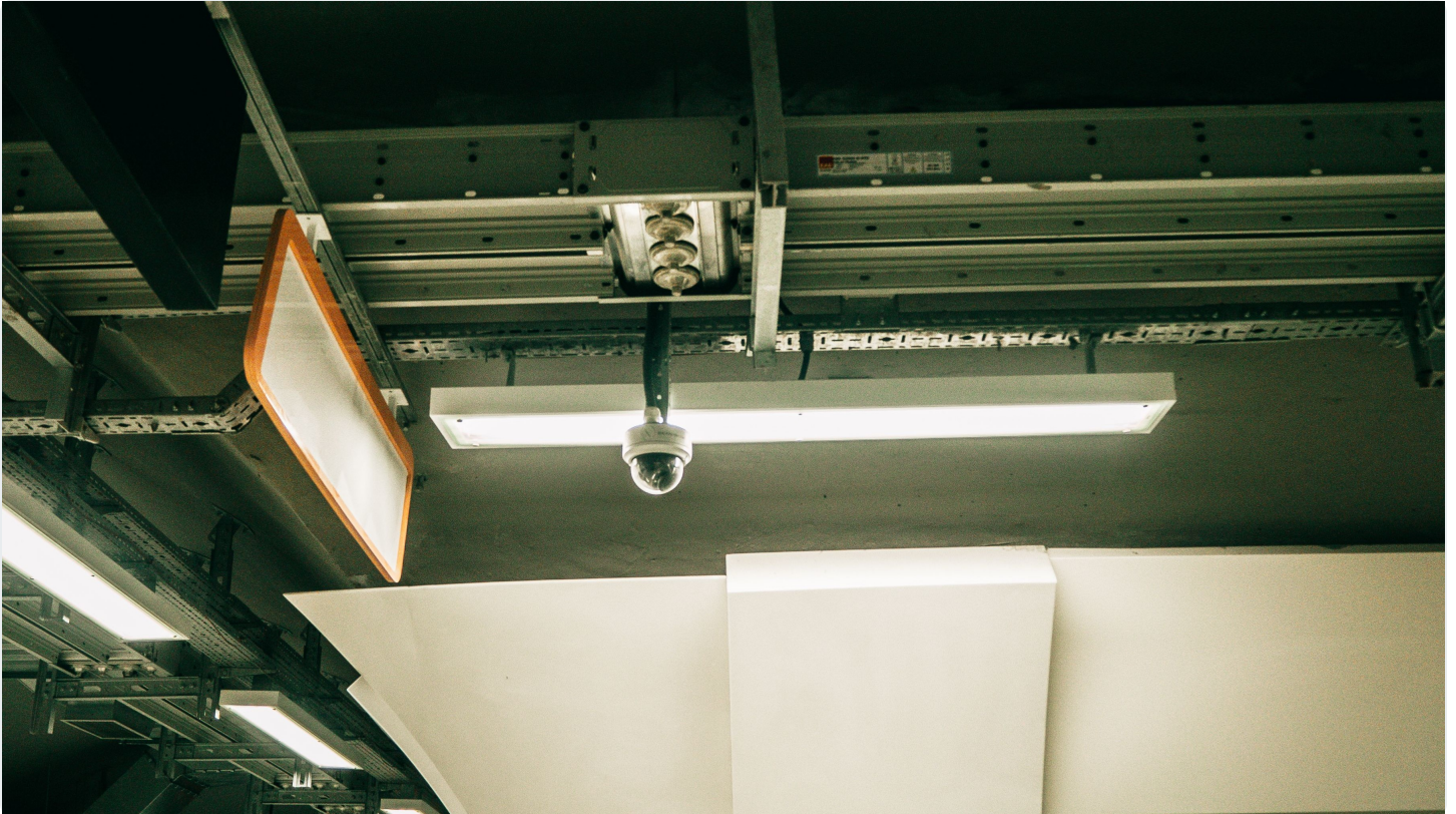
7. Cámara domo instalada en una infraestructura de uso público, vinculada con la planificación de ubicaciones, iluminación y cobertura del sistema de vigilancia.
