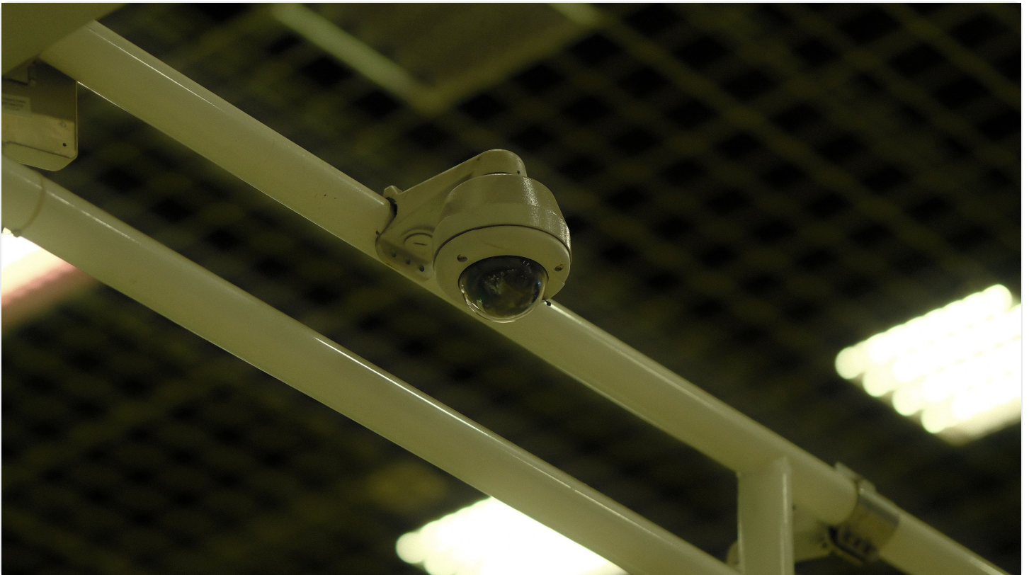
8. Sistema de cámaras montado en una estructura elevada, utilizado para ampliar el campo visual y controlar áreas extensas o puntos estratégicos.
