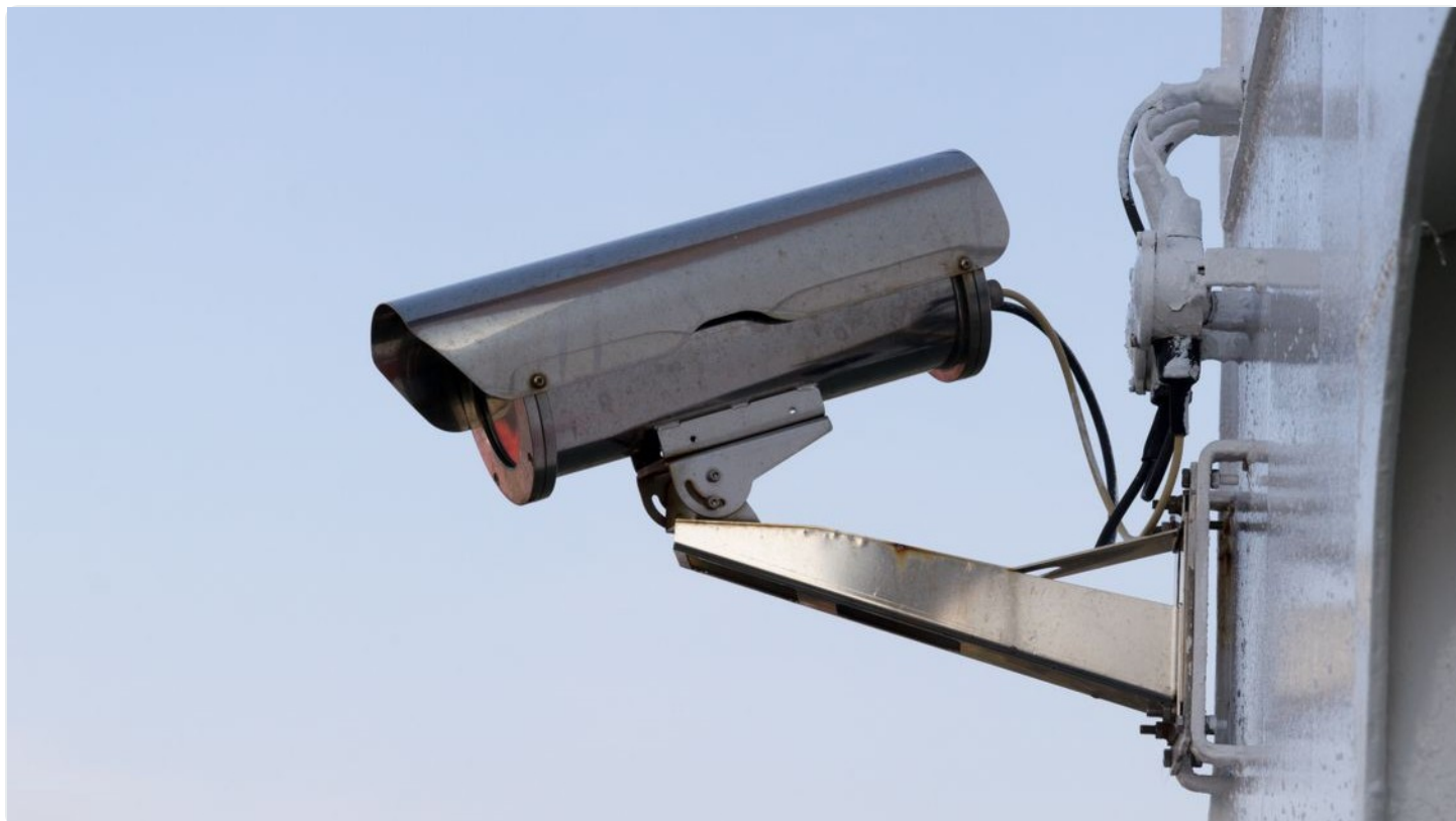
1. Cámara CCTV exterior instalada para vigilancia perimetral y control preventivo de instalaciones, vinculada con los contenidos sobre sistemas de videovigilancia y protección de espacios.
