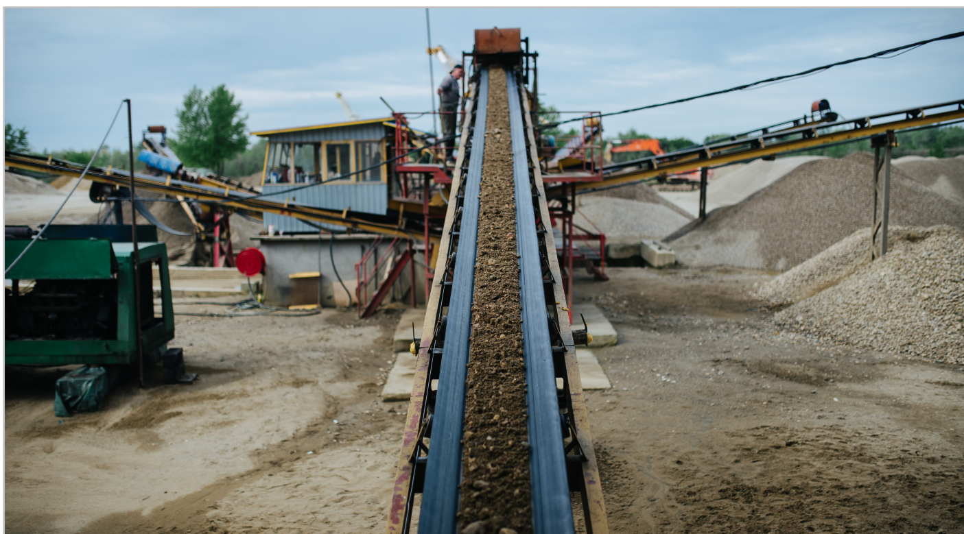
Foto 10. Cinta transportadora utilizada para mover áridos en una instalación industrial. El transporte continuo optimiza la carga, el procesamiento y el almacenamiento de materiales.
