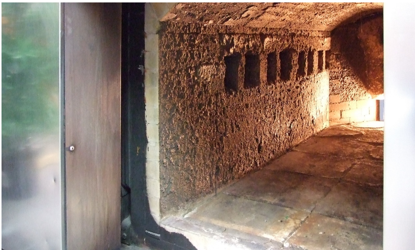
Foto 9. Interior de la cámara de un horno crematorio: fotografía útil para reconocer materiales refractarios, estructura de la cámara y condiciones asociadas a la energía calorífica del proceso.
