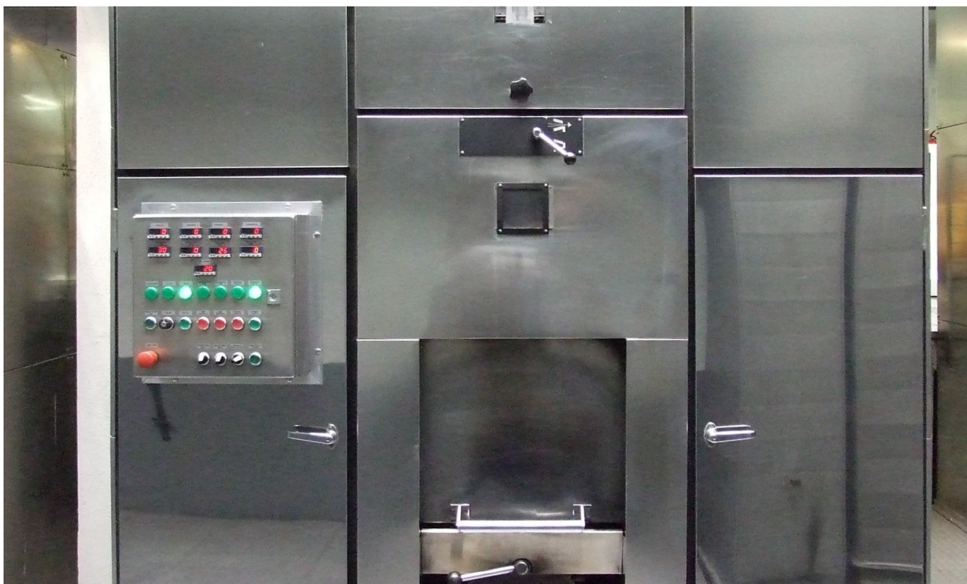
Foto 8. Parte posterior de un horno crematorio: permite observar componentes técnicos, ventilación, controles y estructura general de una instalación moderna de cremación.
